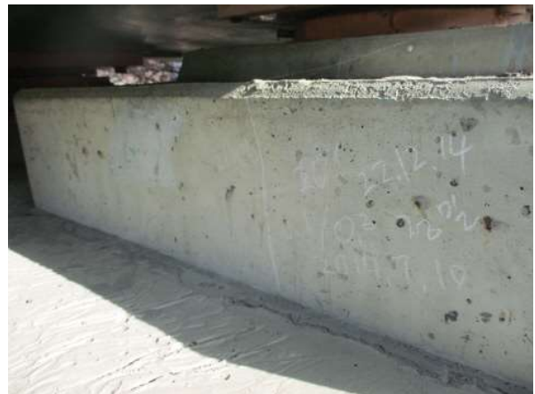
P3 Sh2 받침콘크리트 균열(Cw=0.1mm/0.3m)
