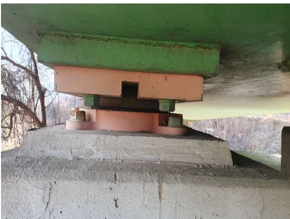
P1 받침 부식 임시조치(도장보수) 전 현황
