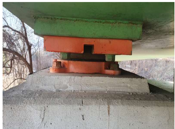
P1 받침 부식 임시조치(도장보수) 전 현황
