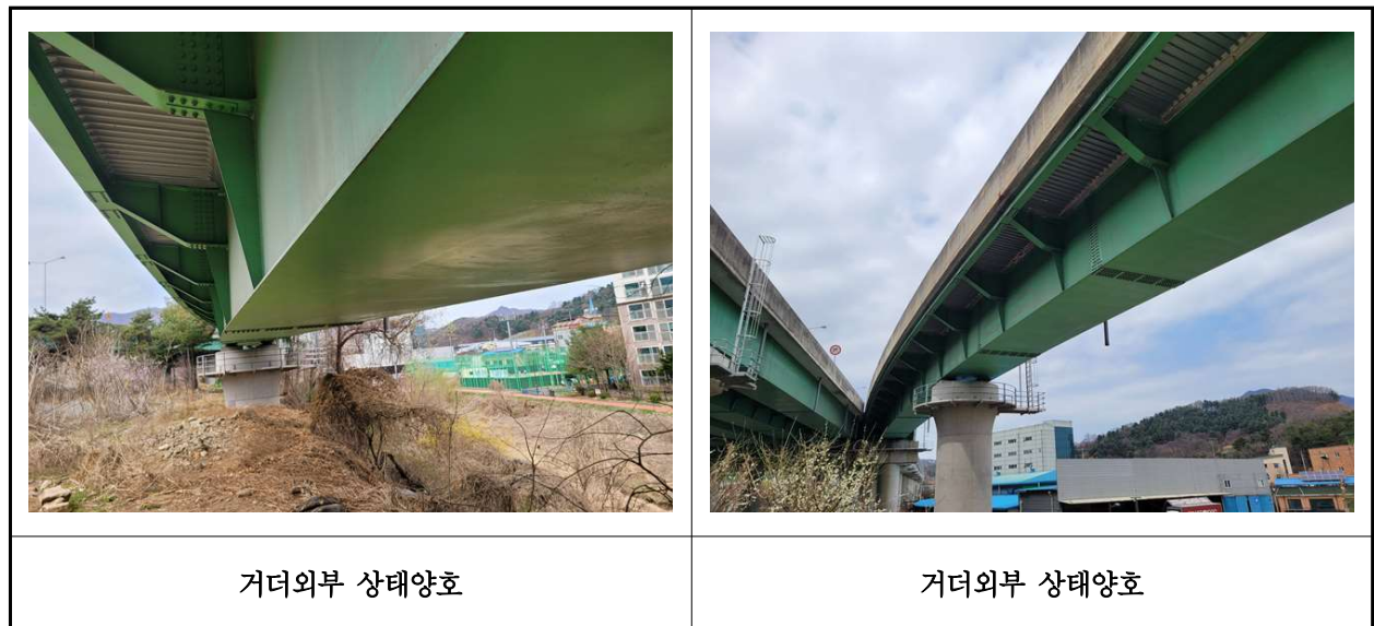
【사진 5.3.5】 거터외부 손상현황
